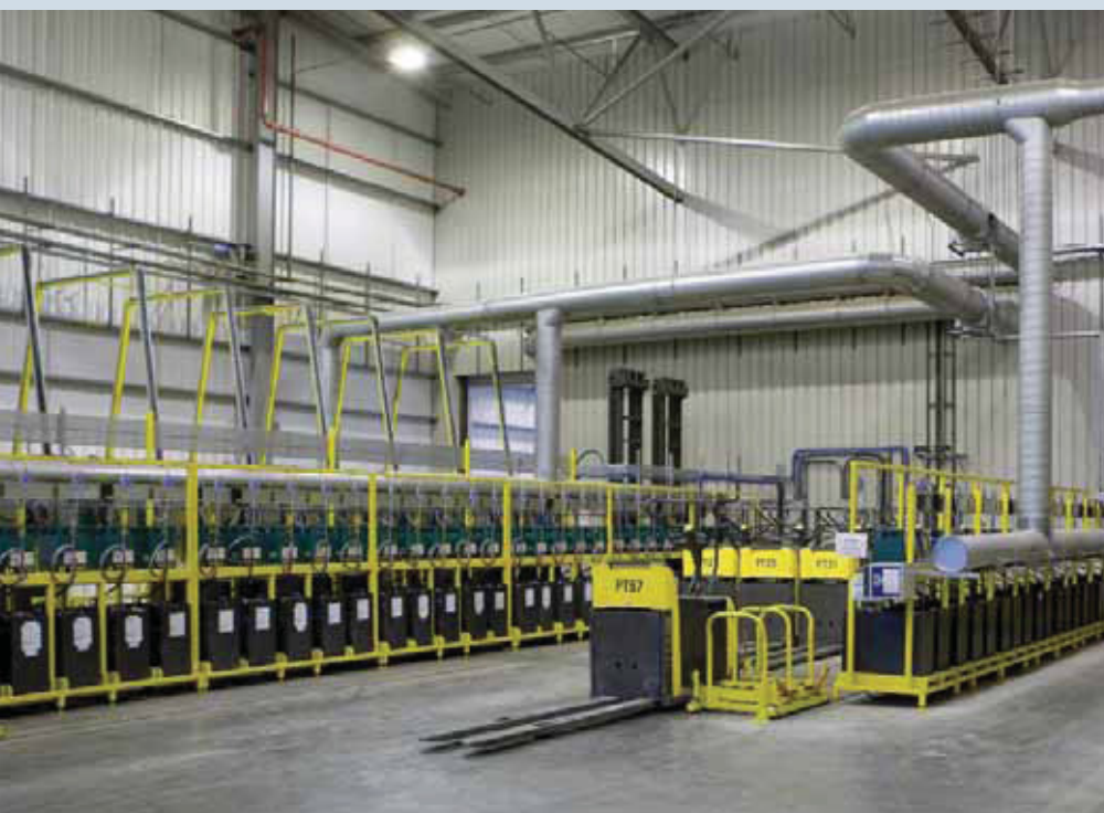
Batteriewechselstation. Alle Gewerke aus einer Hand: Belüftungsanlage, Elektroinstallation, Bodenbeschichtung
