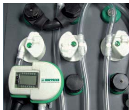
Der trak® com IQ hier auf einer Blei-Antriebsbatterie installiert.
