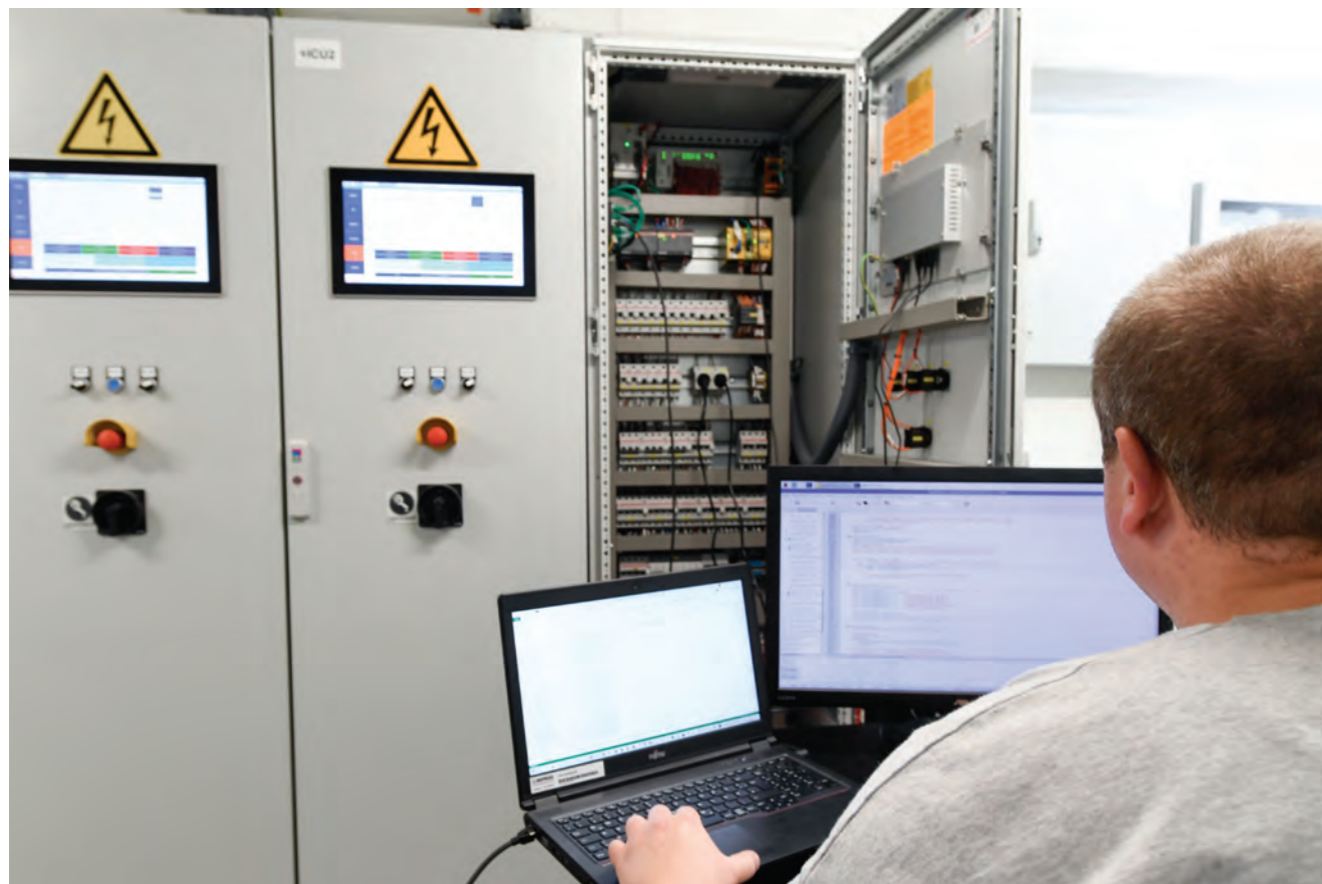
Inbetriebnahme eines Batteriespeicher-Netzwerks durch einen INTILION ESS Mitarbeiter Commissioning of a battery storage network by an INTILION ESS employee
